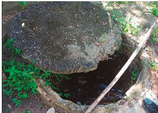
Figura 8 – Poço desativado no terreno de Sr. Raimundo
